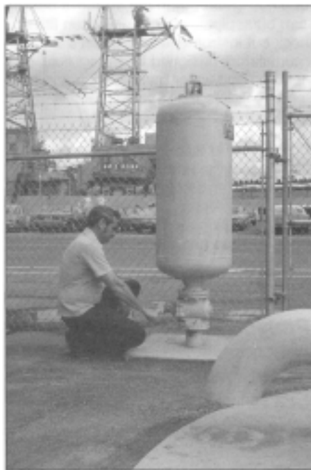
炼油厂——吸收由于油泵启动和 停机所产生的冲击
